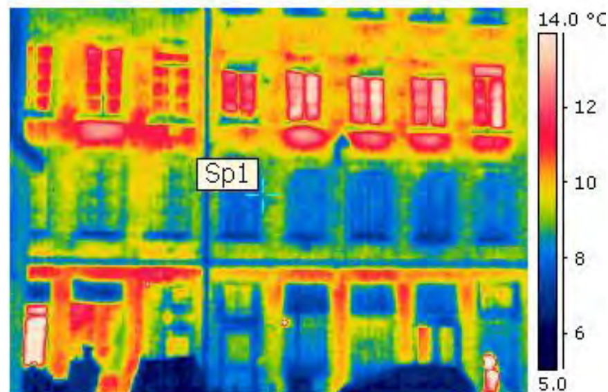
Thermographie de la façade. (rouge = chaud, ce n'est pas bon.) Photographies : ThermiFluides.
