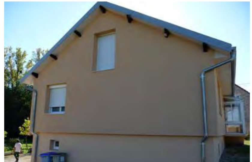
Une maison isolée par l'extérieur. Le raccordement avec le sol n'est jamais simple à exécuter.
